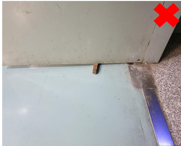
設置門趾影響防火區劃，導致火勢/濃煙蔓延，增加危險。
