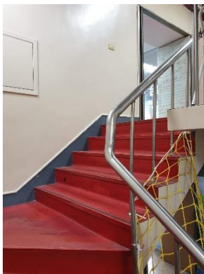
安全梯 / 直通樓梯
